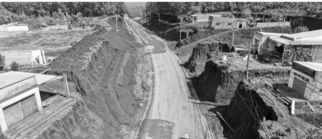
● Một đoạn nền đường ĐT.753 bị hạ thấp khiến nhiều nhà dân nằm chênh vênh trên cao có nguy cơ sạt lở, nguy hiểm.
