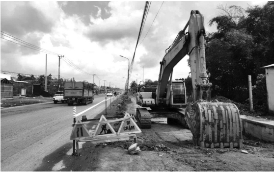
● Sau gần hai năm khởi công, dự án vẫn dang dở. (Ảnh trong bài: Văn Anh)
