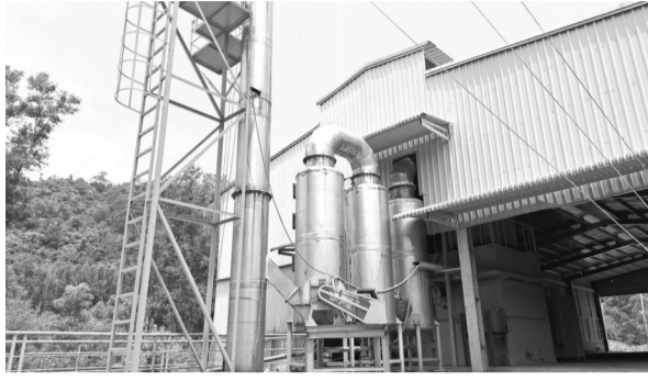
● Lò đốt rác đã hoàn thành xây dựng và hiện vẫn chờ vận hành.
