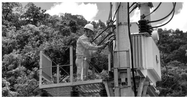
● Ngành Điện tăng cường kiểm tra, bảo đảm cung ứng điện trong cao điểm nắng nóng. (Ảnh: PV)
