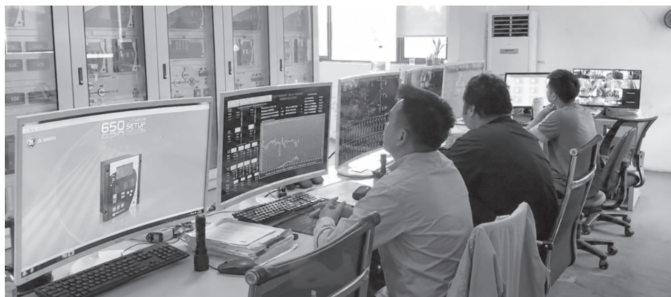
● Phòng giám sát các nguồn điện thu từ điện mặt trời và hệ thống nhiệt dư của Công ty FLAT.
