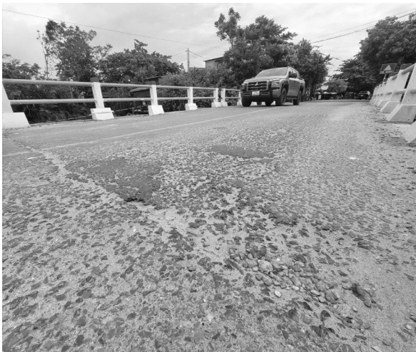
● Tại cầu Bồ Bản, khu vực nhịp 2 và nhịp 3 có tình trạng sụt lún, mặt đường xuất hiện nhiều đoạn trũng xuống.
