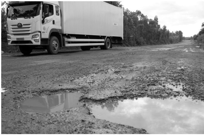
● Sở Xây dựng đánh giá, sau hơn 10 năm khai thác, nhiều đoạn tuyến ĐT558D đã xuống cấp nghiêm trọng. (Ảnh: Minh Phương)
