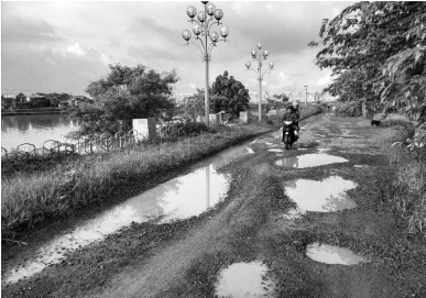
● Một số đoạn trên tuyến đường Bà Triệu chưa được hoàn thiện, xuất hiện nhiều “ô gà, ô voi”. (Ảnh: Trần Tuyền)
